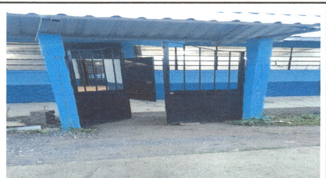
Foto 4: Cambios de techado del porton
